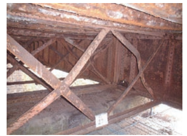
図 対傾構座屈状況
