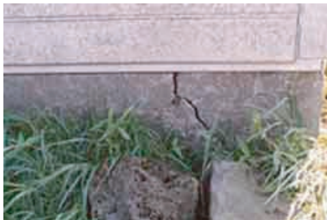
図 ひび割れが発生している基礎
