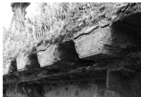
写真-3 床版損傷状況
