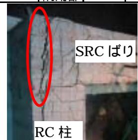
写真-1 終局時ひび割れ状況(鋼板あり)
